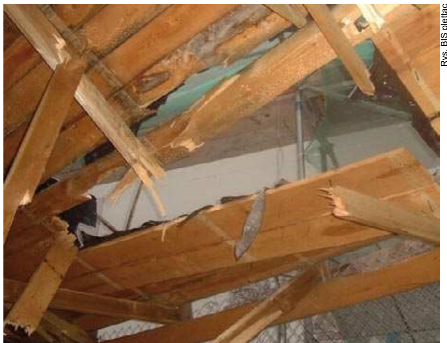
Rys. 8. Efekt awarii wysięgnika transportowego – przebiecie daszka ochronnego
