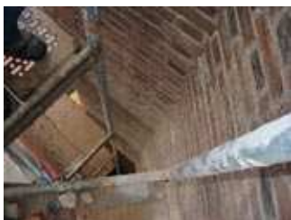
Fot. 10. Brak zastosowania pomostów narożnych lub bali drewnianych
