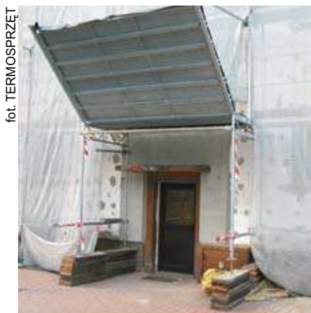
Fot. 2b. Posadowienie nieprawidłowe
