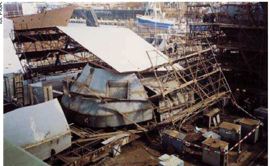
Fot. 9. Efekt katastrofy budowlanej na terenie stoczni w Gdyni
