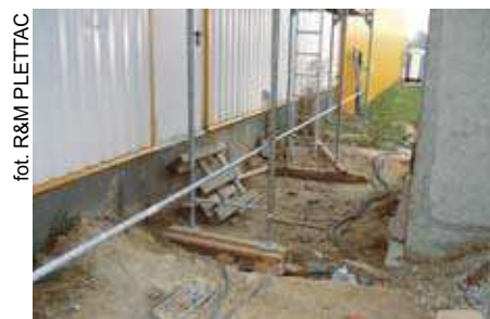
Fot. 3. Posadowienie nieprawidłowe
