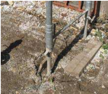
Fot. 6. Posadowienie nieprawidłowe
