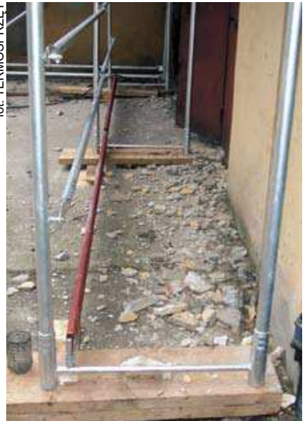
Fot. 7. Posadowienie nieprawidłowe
