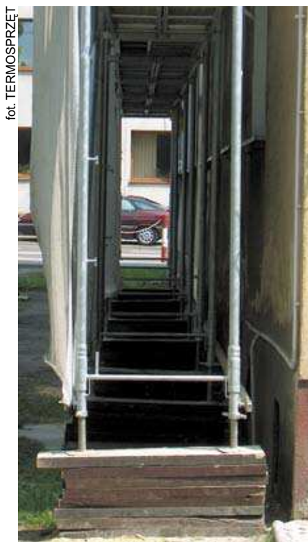
Fot. 2a. Posadowienie nieprawidłowe
