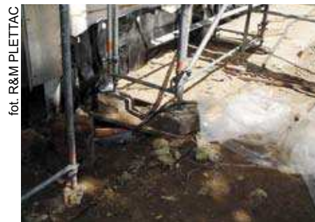
Fot. 4. Posadowienie nieprawidłowe
