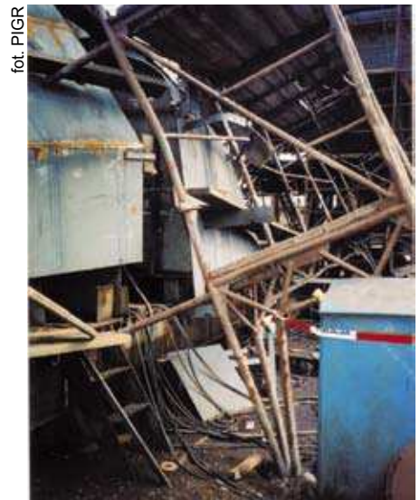
Fot. 8. Wadliwe posadowienie rusztowania na terenie stoczni w Gdyni
