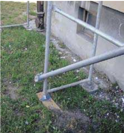
Fot. 5. Posadowienie nieprawidłowe
