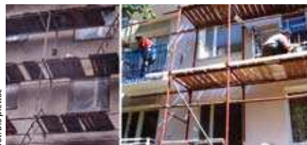
Fot. 6. Przykłady błędów montażu rusztowań stojakowych z rur
