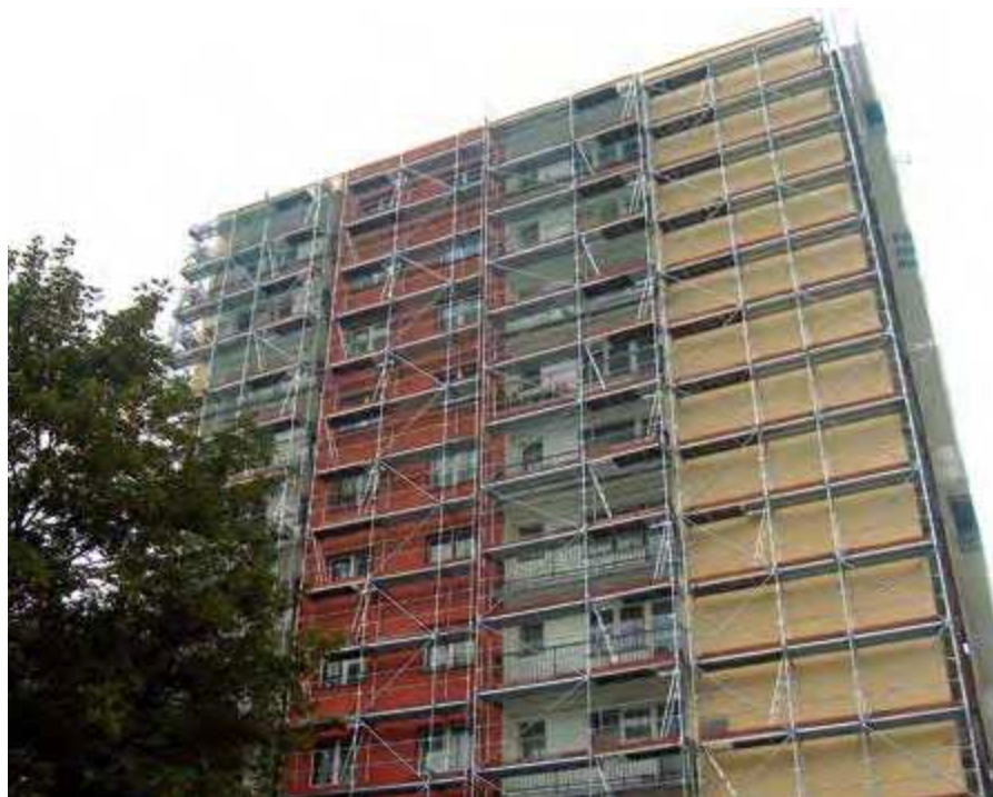
Fot. 2. Konstrukcja stężona prawidłowo - stężenia poziome realizowane za pomocą podestów systemowych, stężenia pionowe w układzie wieżowym
